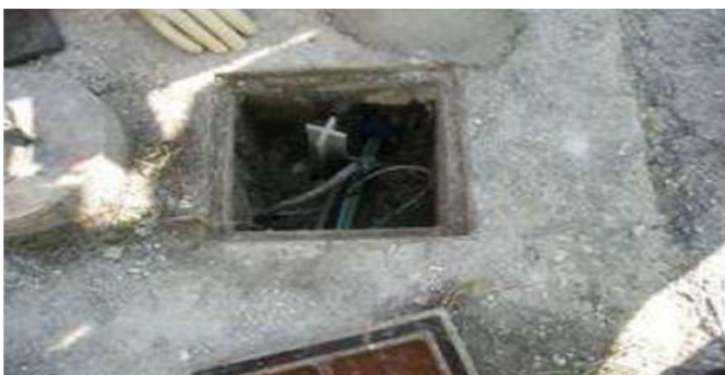
Fig.3: Pozzetto della pubblica illuminazione aperto con il transit all'interno dei 2 minitubi di TI.
