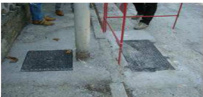
Fig. 1: I pozzetti che ospitano le infrastrutture degli Enti e di TI debbono necessariamente essere separati. Nella Foto il pozzetto della pubblica illuminazione (a sx) e il pozzetto di TI (a dx).
